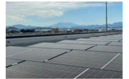
湘南研究所の太陽光発電設備
