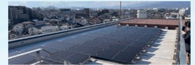
屋上に設置した太陽光パネル
